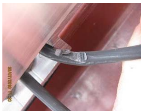
Utilisation d'un outil inadéquat
