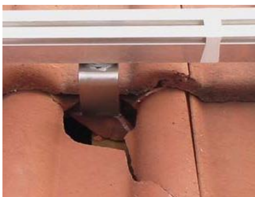
Erreur de montage = tuile cassée
