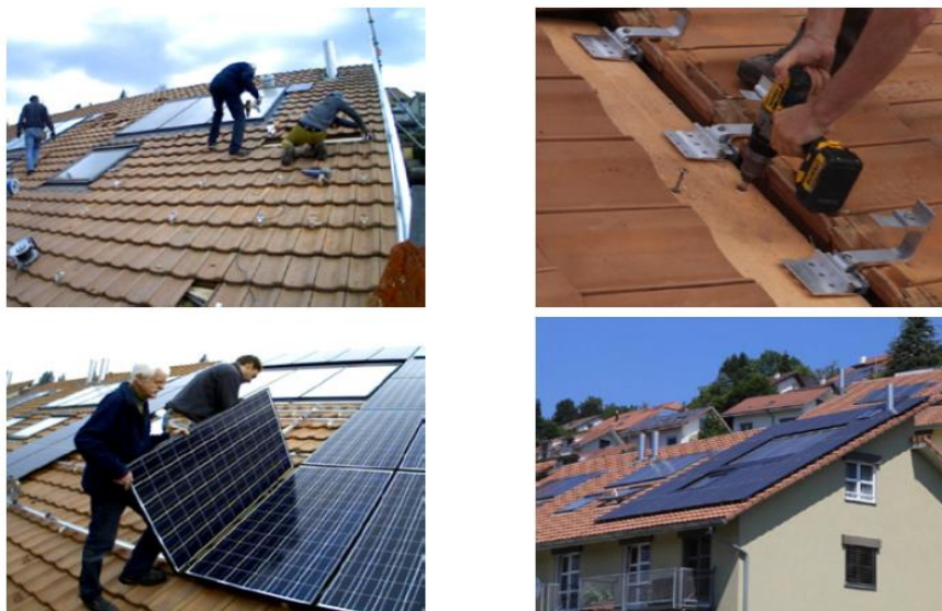
Fig. 1. Montage d'une installation en autoconstruction par la Coopérative EWG à Stettlen (BE), en mars 2017.
