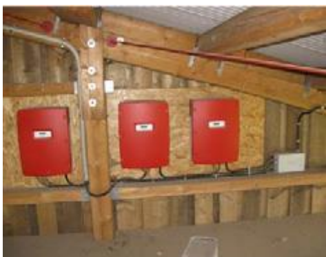
Il faut une autorisation spéciale pour installer des onduleurs sur une surface en matériau combustible
