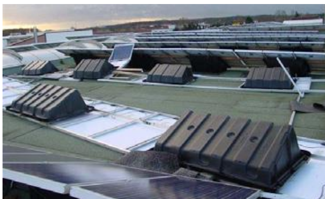
Dégâts après le passage d'une tempête. Cause: une mauvaise disposition des poids de lestage 69
