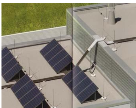
Les câbles doivent passer dans des gaines techniques ignifugées
