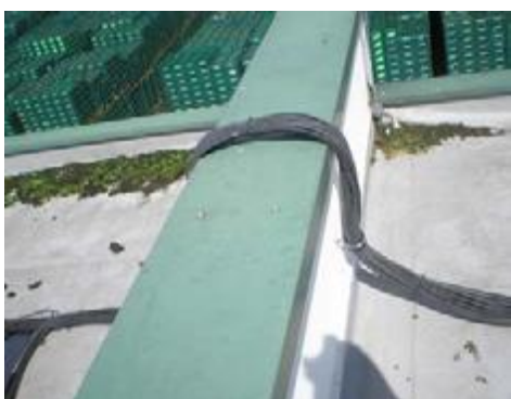
Le passage d'un câble par-dessus un mur pare feu est interdit.
