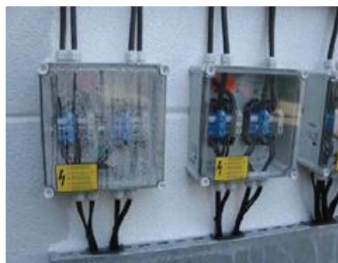
De la condensation dans la boîte de jonction qui n'est pas étanche; risque de court-circuit et d'incendie
