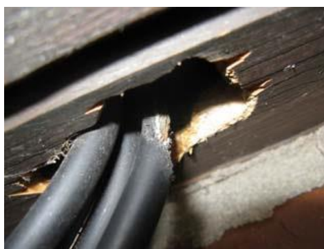
Dégâts dus au frottement
