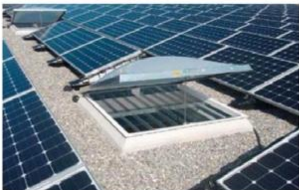
Puits de lumière avec grille de protection 35
